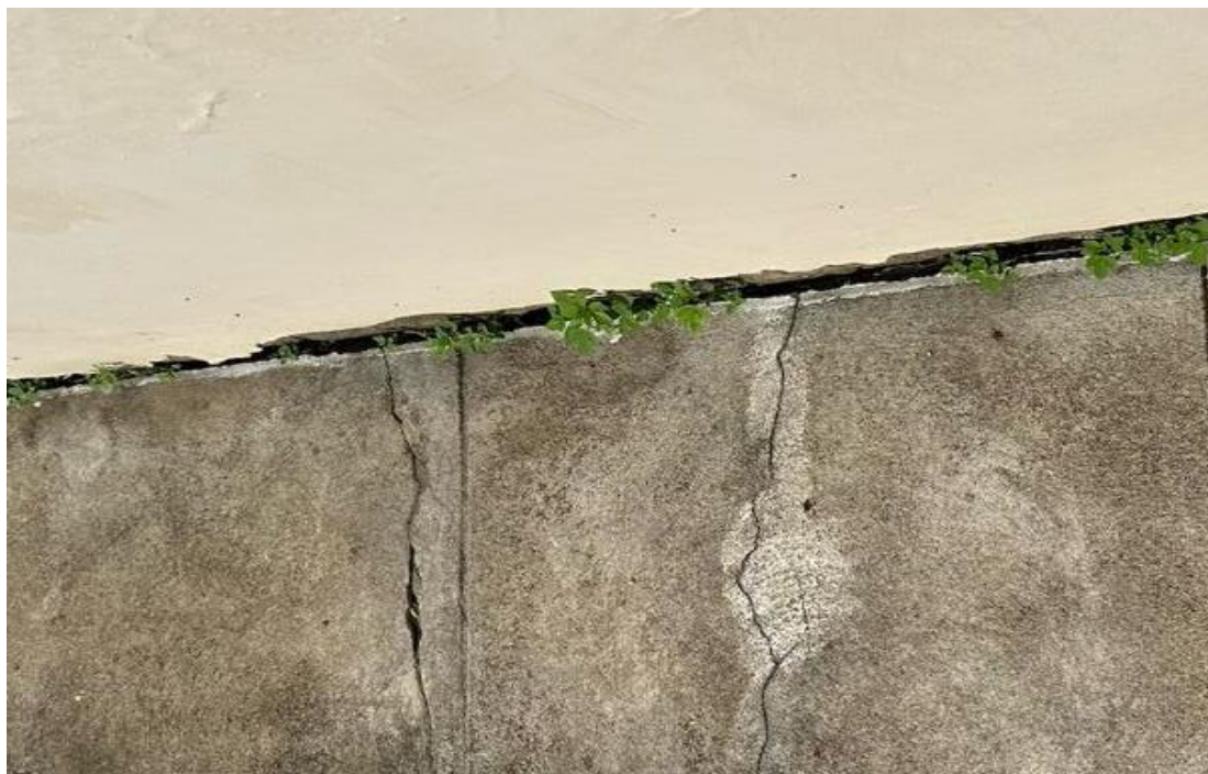
Figura 5 – Parede externa com reboco deteriorado, expondo a alvenaria, calçada c
