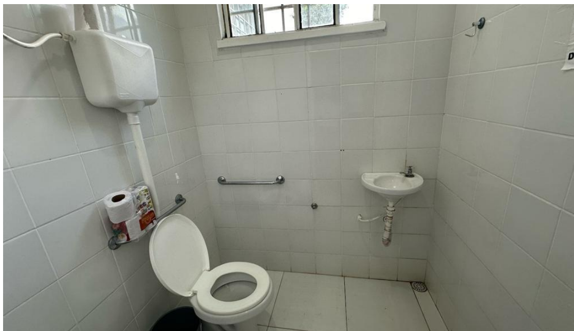
Figura 6 - Banheiro fora dos padrões da NBR 9050, com ausência de barras de apoio adequadas e espaço insuficiente para acessibilidade.
