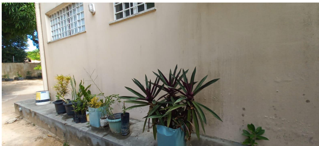
Figura 13 - Paredes externas apresentando necessidade de revitalização e pintura.
