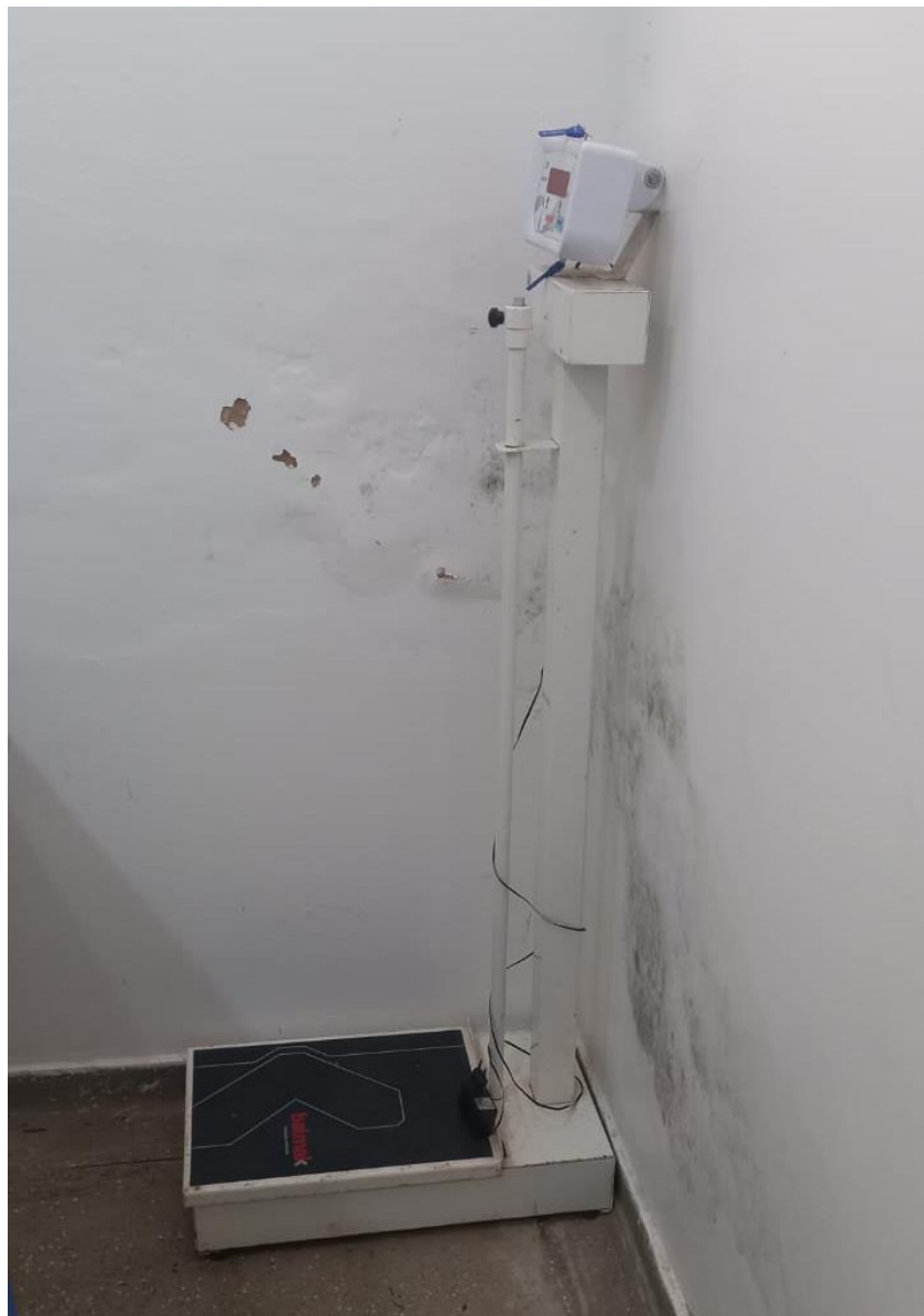
Figura 10 - Presença de sinais de infiltração nas paredes das salas de atendimento.
