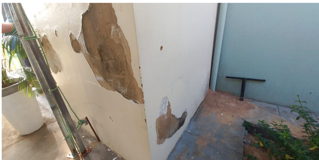
Figura 2 – Parede externa com reboco deteriorado, expondo a alvenaria e indicando sinais de infiltração e desgaste.
