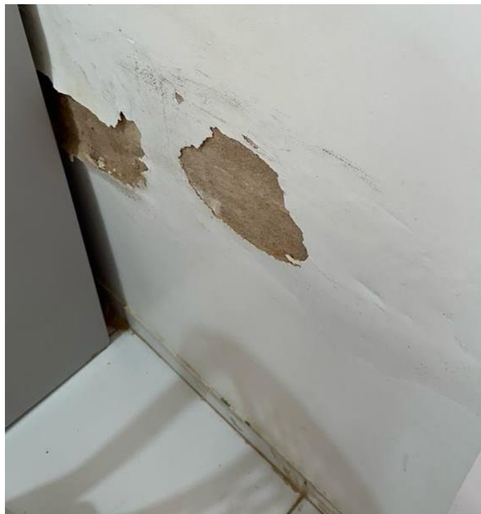
Figura 3 – Parede interna com reboco deteriorado, expondo a alvenaria e indicando sinais de infiltração e desgaste.
