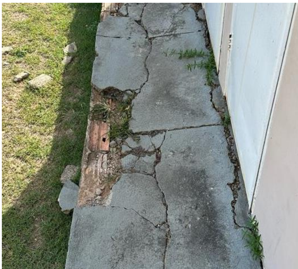
Figura 4 – Calçada lateral com piso quebrado e irregular, apresentando fissuras e vegetação
