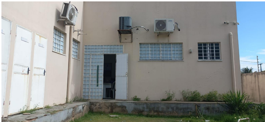
Figura 14 - Paredes externas apresentando necessidade de revitalização e pintura.
