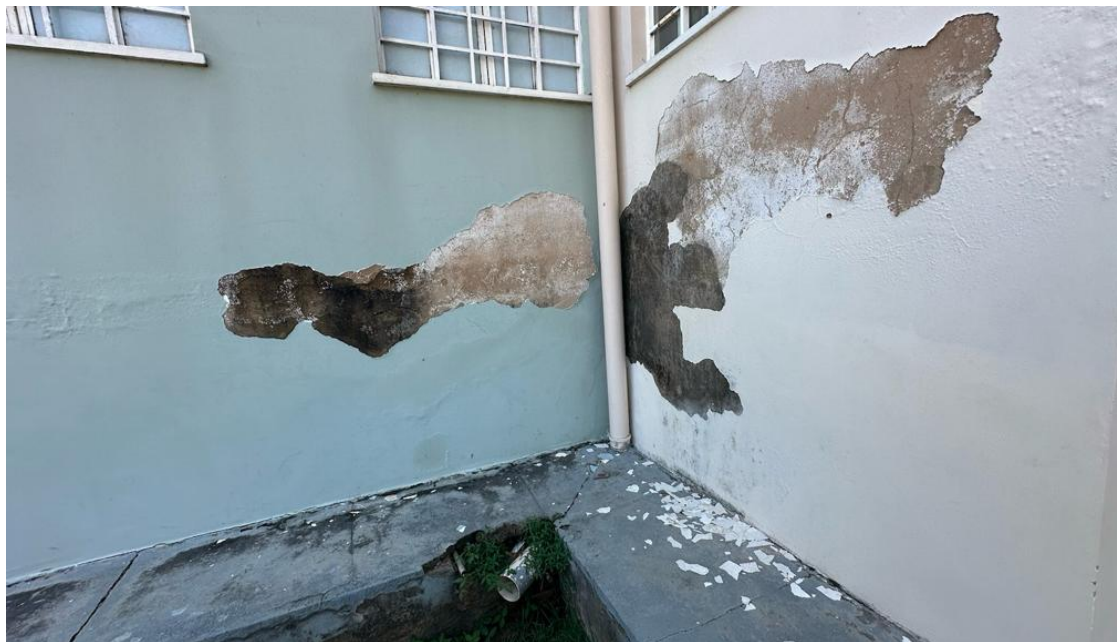
Figura 1 – Parede externa com reboco deteriorado, expondo a alvenaria e indicando sinais de infiltração e desgaste.
