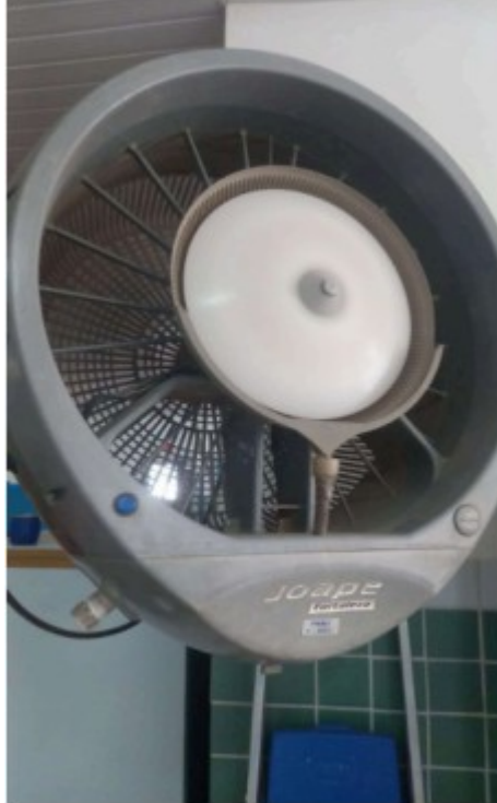
Climatizador fixo em parede
